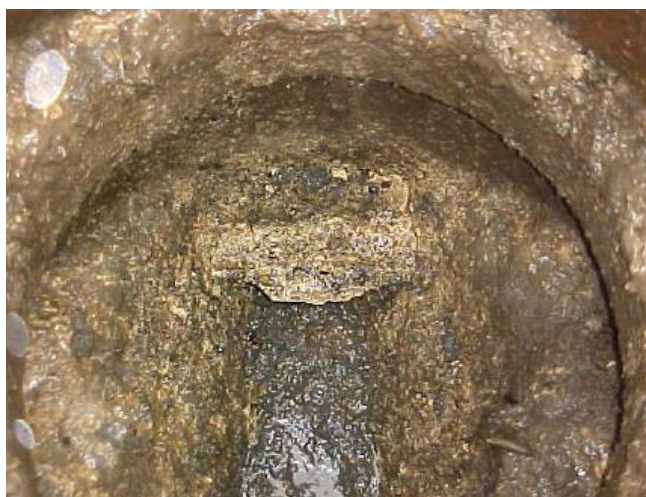
Figura 3.2.1-1 Poço de visita obstruído.
